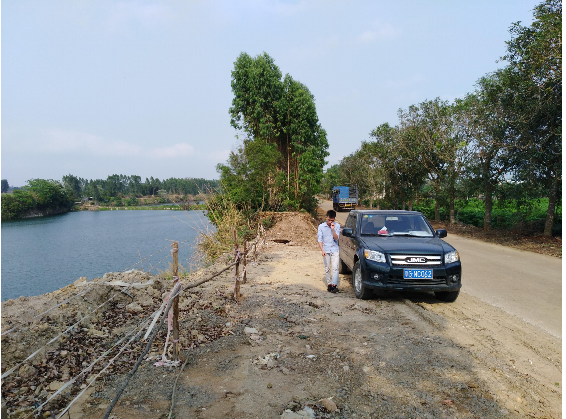
照片 2 矿坑边坡崩塌
